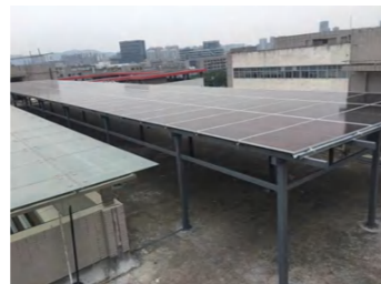
图：光伏项目的太阳能板材
